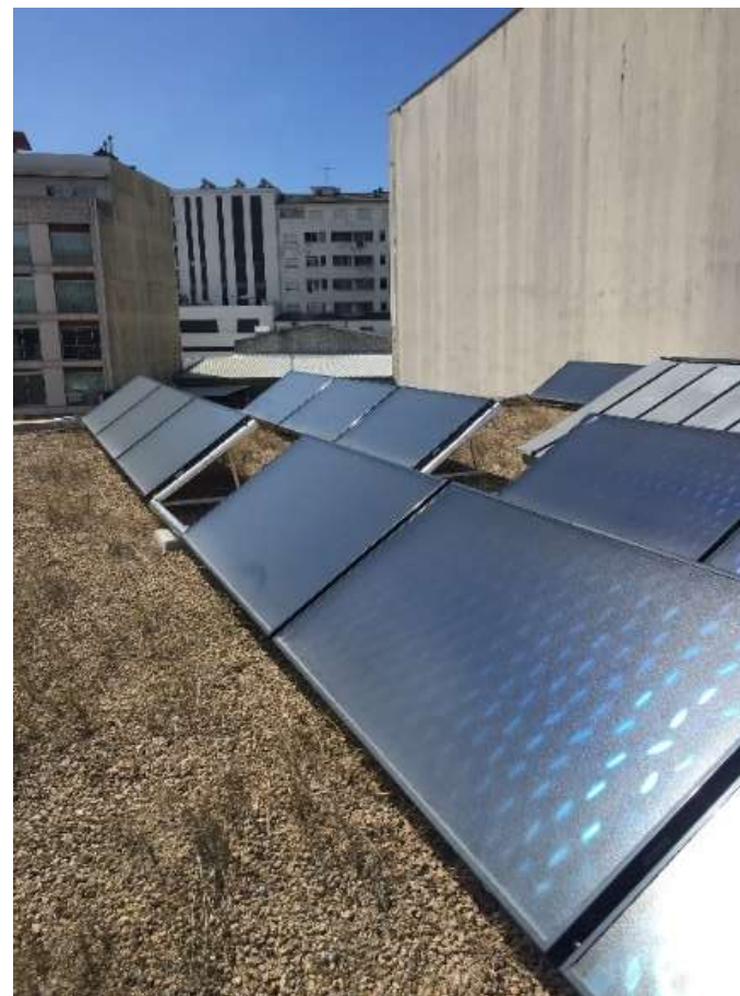
Figura 4 – Painéis solares fotovoltaicos instalados no Pavilhão Desportivo Municipal (Fonte: Câmara Municipal de Santo Tirso)
