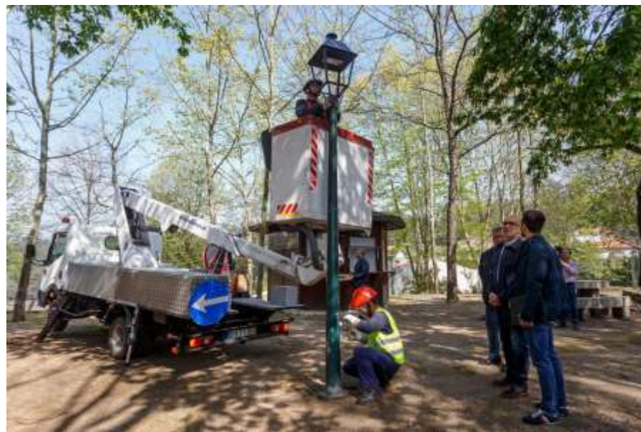
Figura 3 – Instalação de luminárias LED no Município de Santo Tirso (Fonte: Câmara Municipal de Santo Tirso)
