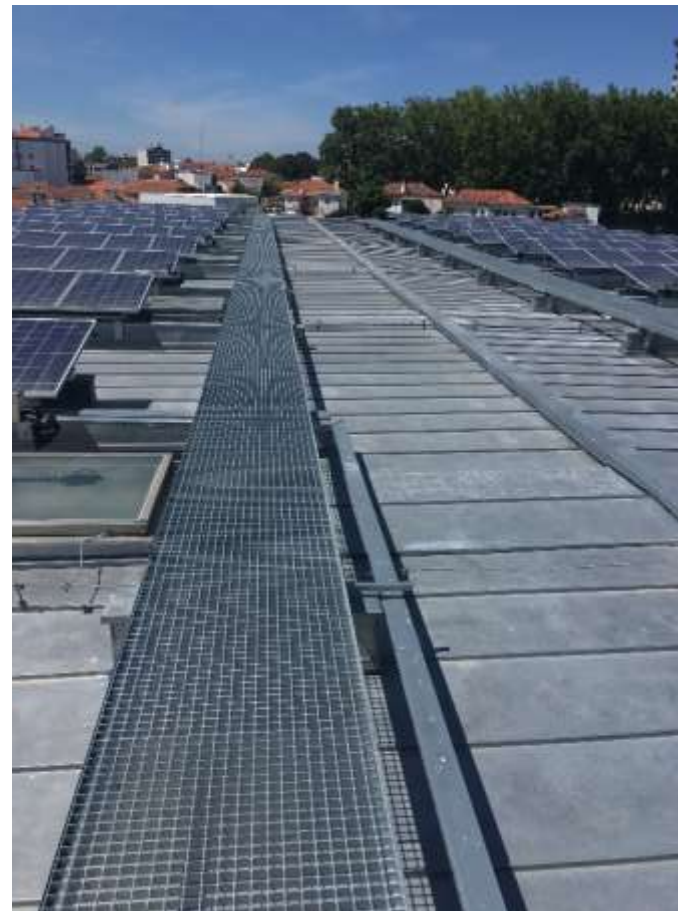
Figura 5 – Painéis solares fotovoltaicos instalados no Pavilhão Desportivo Municipal (Fonte: Câmara Municipal de Santo Tirso)
