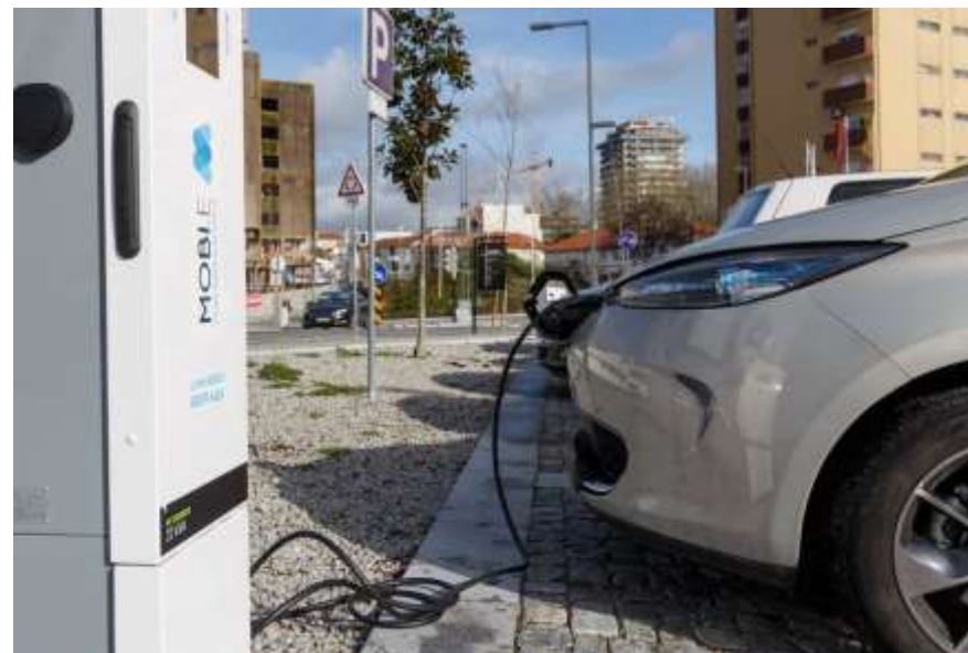
Figura 6 – Posto de carregamento para veículos elétricos (Fonte: Câmara Municipal de Santo Tirso)
